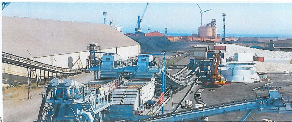
Installation de traitement de la Smil sur le port de Fos-sur-Mer et ses quatre trémies de chargement.
