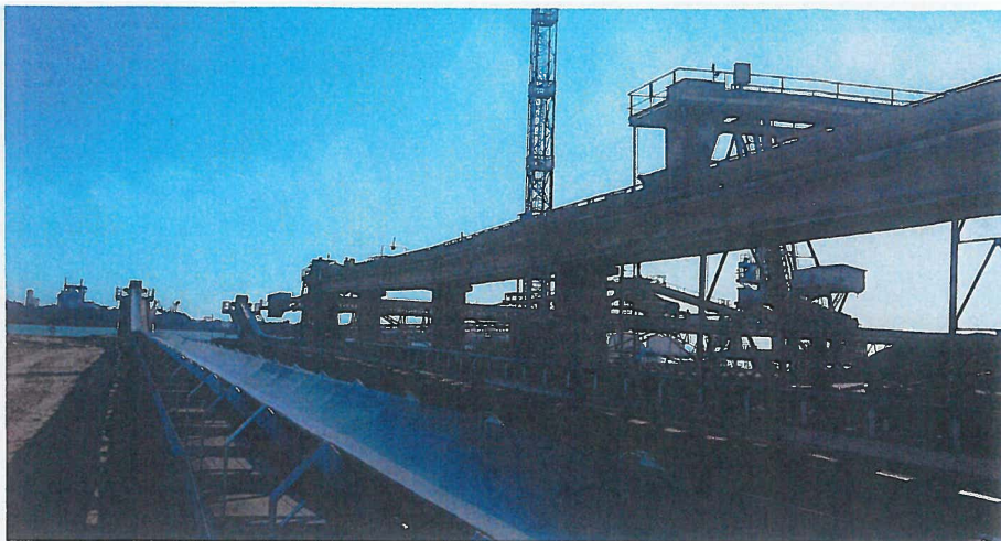
→ Deux convoyeurs d'une capacité chacun de 1 000 tonnes/heure assurent la manutention du granulat jusqu'au quai de chargement Bateaux.
