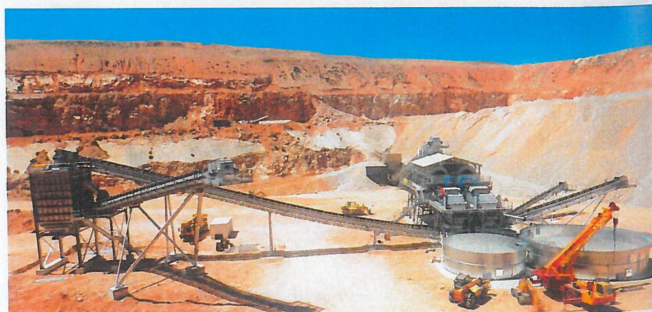
→ La nouvelle installation de Châteauneuf-les-Martigues assure le traitement nécessaire pour répondre aux contraintes environnementales et techniques de l'extension de Monaco.
