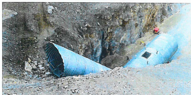
→ Tunnel de reprise avec tunnel de secours permettant un accès rapide et sécurisé depuis les bâtiments.
