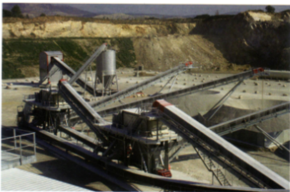
► Le site de Salon - Lançon-de-Provence a une capacité de production de 400 000 tonnes par an / The quarry of Salon - Lançon-de-Provence has an annual output capacity of 400,000 tons (doc. Agence SCHILLING).
